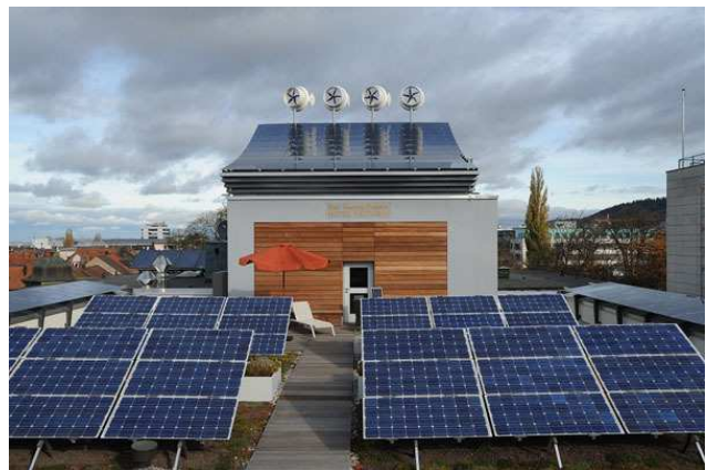
Die Solaranlage auf dem Hoteldach
